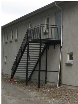
Bilde 30. Utvendig rømningstrapp fra fellesområdet for VIP.
