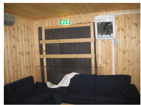
Bilde 26 Rømningsvei fra curlinghallen er ikke tilgjengelig.
