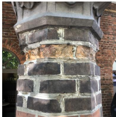
Figur 42 Skader i tegl.
