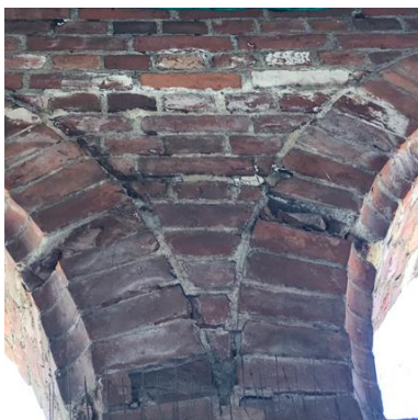
Figur 45 Funktskader og frostsprengning.
