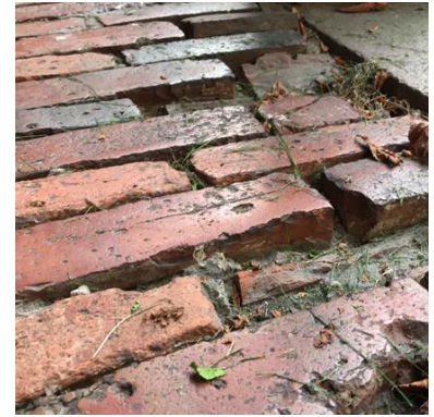
Figur 68 Skader i dekke med snublefare.
