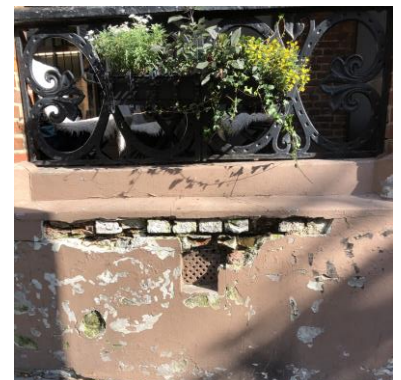
Figur 47 Skader pussede flate sokkel.
