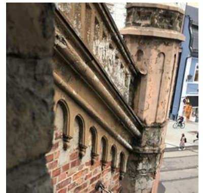
Figur 119 Fare for nedfall av puss og tegl fra fialer.
