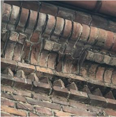
Figur 120 fare for nedfall av tegl i båndgesims.
