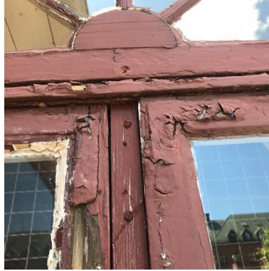
Figur 60 Typisk skade vinduer brannvakt.
