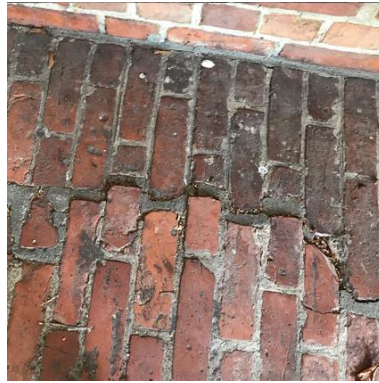
Figur 67 Skader i tegldekke indre buegang på grunn av setninger.
