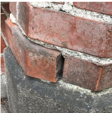
Figur 117 Søyلة i indre buegang med konstruktiv svikt.
