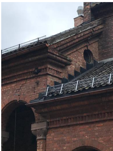
Figur 49 Omfattende skade teglvegg.
