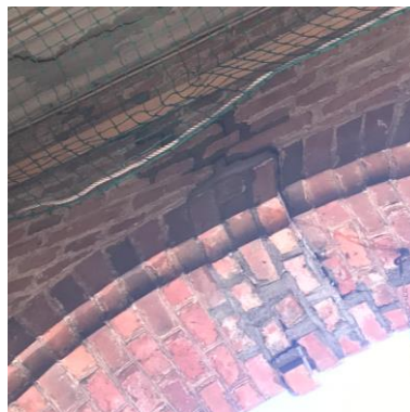
Figur 48 Skader rundbue, med fare for nedfall.
