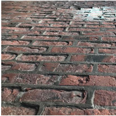
Figur 69 Skader i tegldekke ytre buegang mot Kirkeristen.
