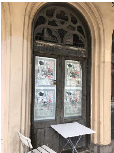
Figur 52 Eldre dør med omfattende skader. Y.B.40.
