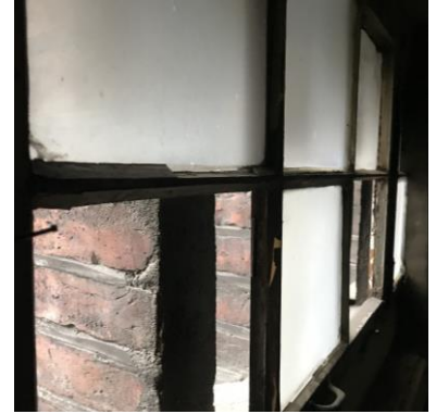
Figur 59 Vindu mesaning, med manglende glass.
