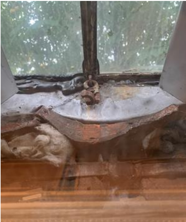
Figur 113 Bilde fra befaring 08.10.2020. Takvindu ved plassering 2.A
