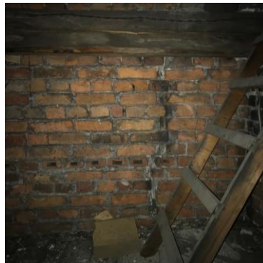
Figur 65 Setningsskade på innervegg.
