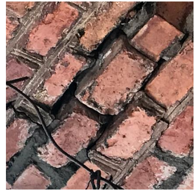
Figur 44 Fare for nedfall av tegl grunnet setninger.
