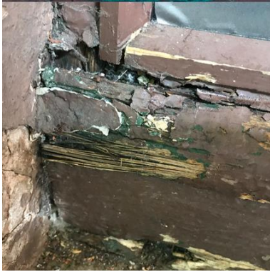
Figur 61 Typiske skader vindu.
