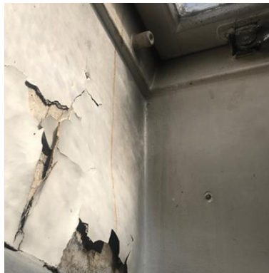
Figur 71 Fuktskade ved nyere overlys.
