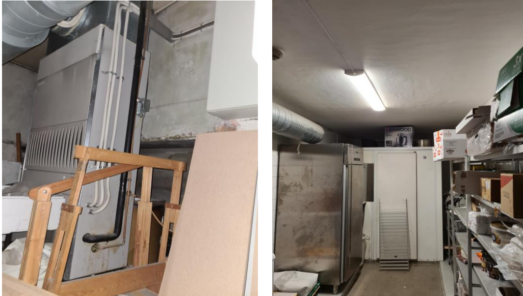
Figur 93 Diverse eksisterende kjøleinstallasjoner.
