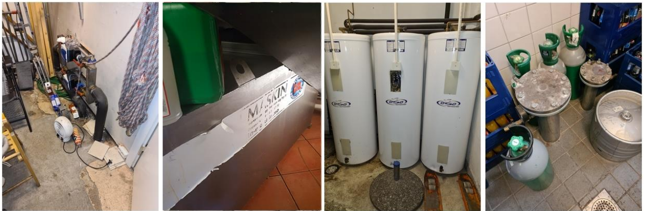
Figur 89 Eksisterende vanninnlegg, fettutskiller, varmtvannsberedere, samt påbegynt sprinklerinnlegg, mm.
