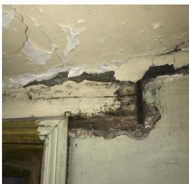
Figur 64 Setningsskader i bevaringsverdig interiør.
