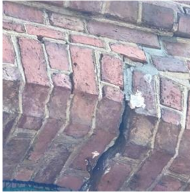
Figur 118 Fare for nedfall av tegl fra rundbuer.
