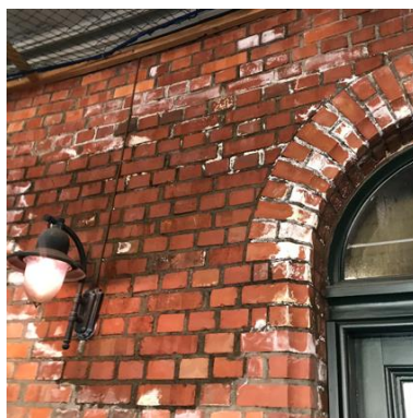
Figur 43 Fukt grunnet bruk.
